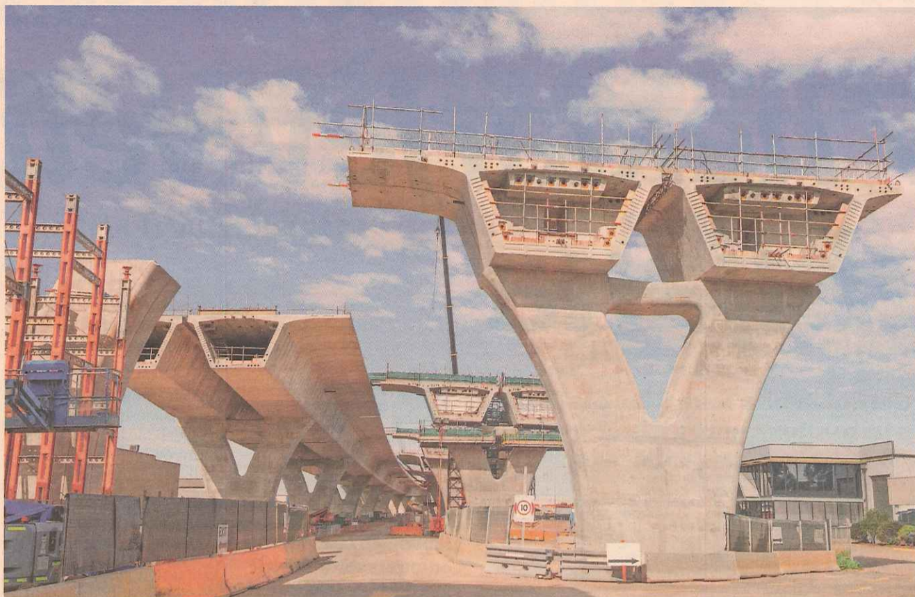
Projektanti bodo morali upoštevati zahteve, povezane s trajnostjo betona, in temu prilagoditi zahteve, povezane s trdnostnim razredom betona in nosilnostjo konstrukcije.
